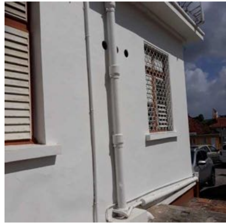
Prélèvement - P622 : Mairie des Trois-Ilets / Bat Ancienne Mairie / Extérieur / Façades - Conduit d'eau pluviale - EP- (Présence d'amiante)
